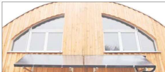
Mit Solarkollektoren, hier über der Terrassentür der Südseite des Hauses angebracht, wird das Wasser im Haus erhitzt.
